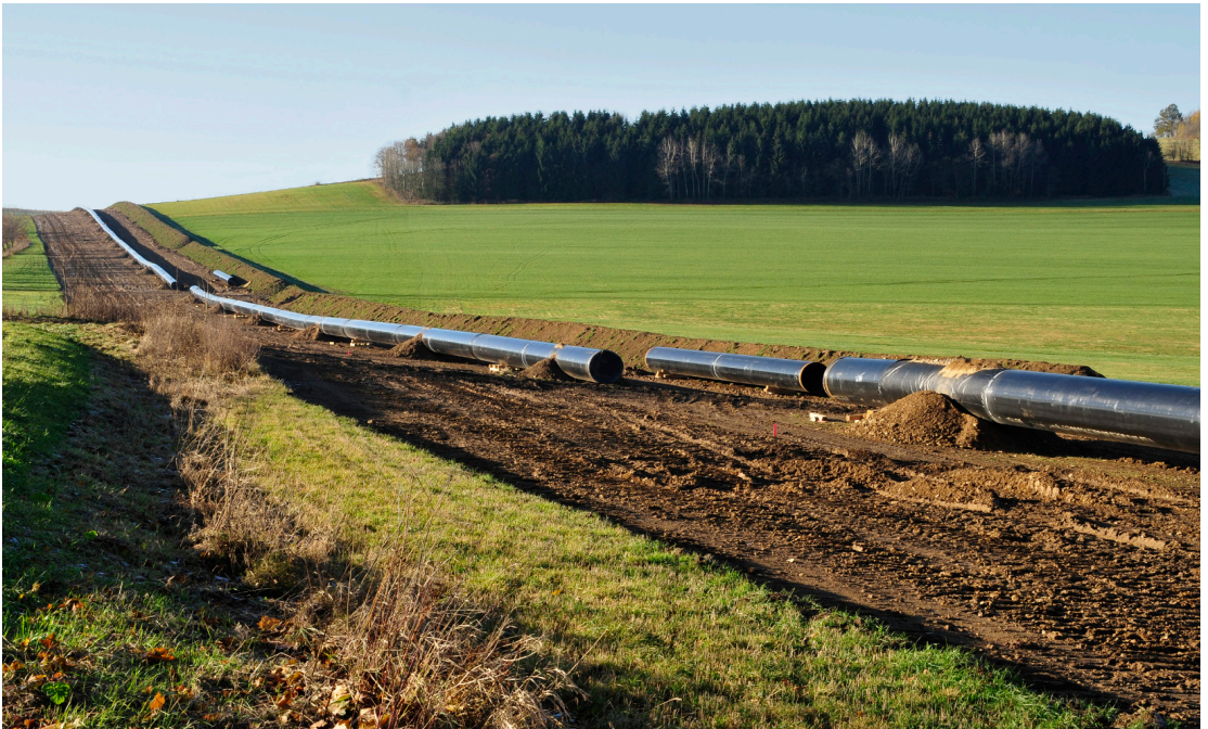
New pipeline infrastructure. | Des nouvelles infrastructures de pipelines.
